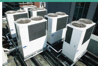
空調の省エネ(GHP、EHP)
